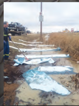
Diesel spill pad use
